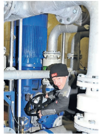
Alles im Griff: Rolf Schnurbus in der Pumpstation Ettelsberg.
